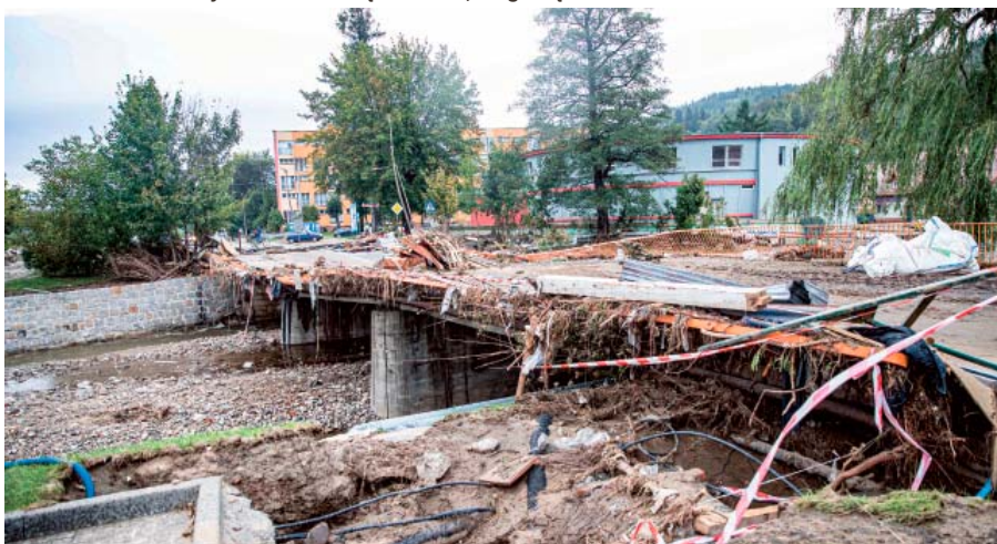
Zniszczone drogi i mosty utrudniają przeprowadzanie akcji pomocowych.
