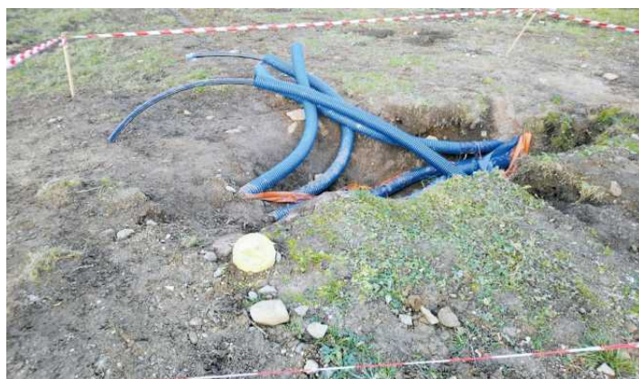
• Prace na wale przy tamie w Stroniu Śląskim FOT. ARCHIWUM PRYWATNE MACIEJA SIWKI
